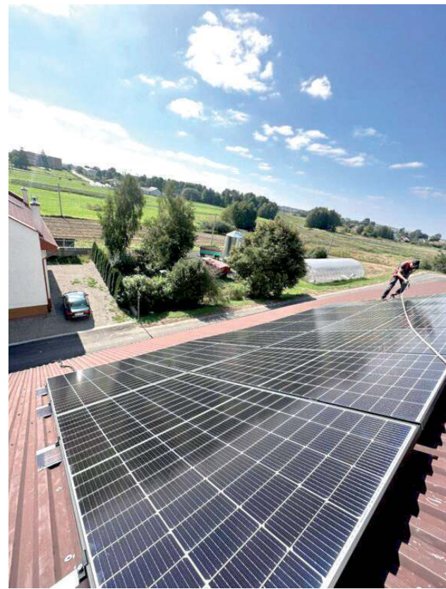
Strażacy z OSP Zamch mają teraz własną instalację fotowoltaiczną
