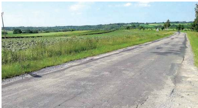
Na razie droga z Wąwolnicy do Poniatoowej wygląda tak – pokruszony asfalt, wyboje i liczne połamania dziur to codzienność kierowców pokonujących tę trasę. Ale, jeśli wszystko pójdzie zgodnie z planem, jeszcze w tym roku pojadą tędy jak po stole
