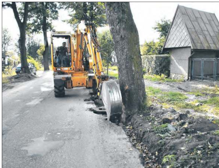
W konfrontacji drzewa kontra nowa jezdnia i krawężniki zwycięzca może być tym jeden
