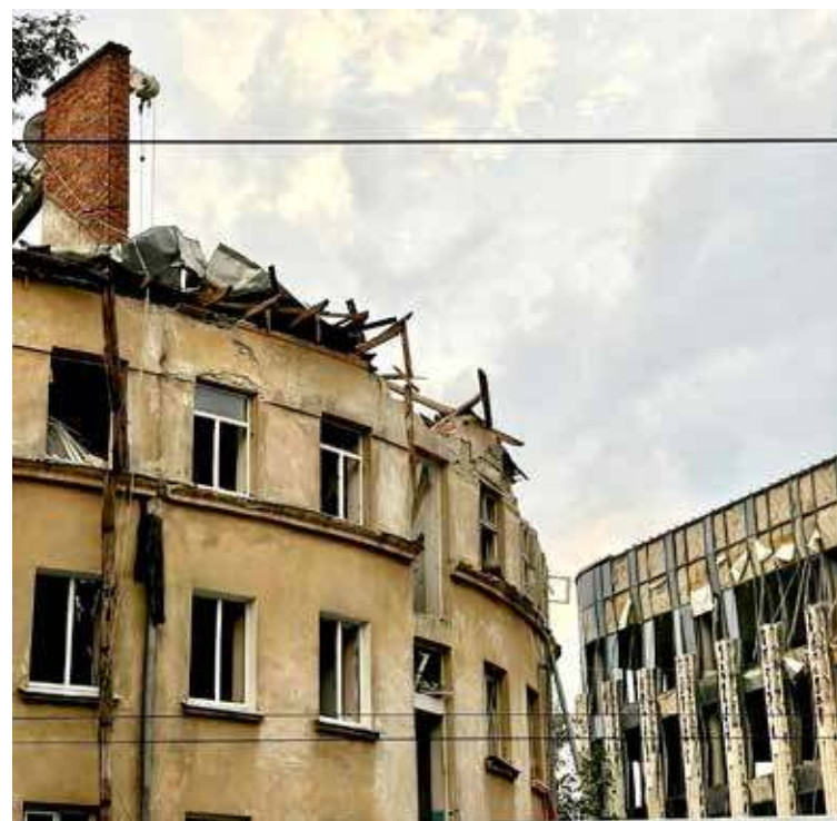
Budynki mieszkalne w które uderzyły Rosyjskie rakiet
