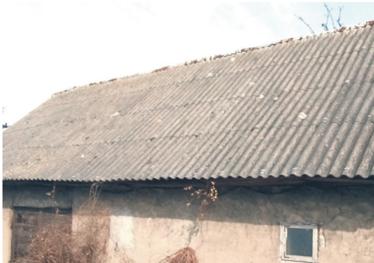
Na wielu budynkach leży jeszcze eternit.
