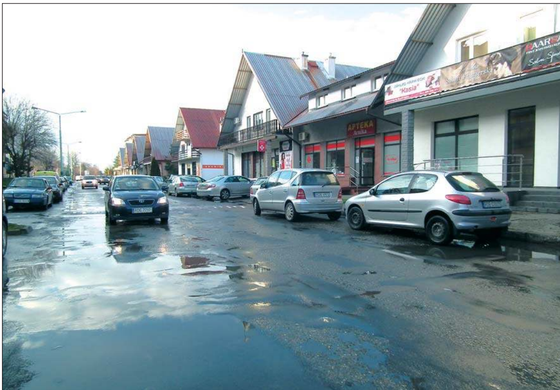
Na ul. Piłsudskiego na razie mieszkańcy mogą liczyć jedynie na bieżące naprawy.
