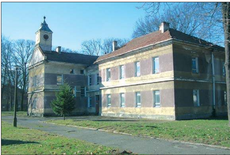
Stan budynku na terenie byłej jednostki pozostawia wiele do życzenia.
