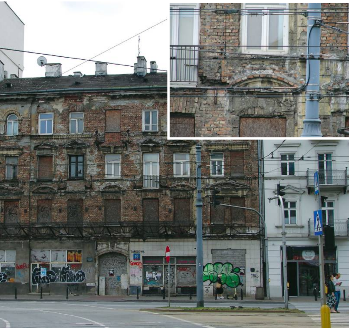
Kamienica przy ul. Targowej 19 i fragment zniszczonej fasady zabytku | fot. Janusz Sujecki/Gazeta Polska
