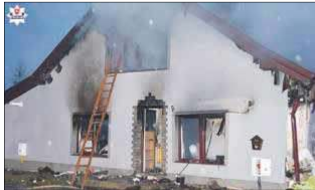
Siła wybuchu bardzo mocno uszkodziła dom
