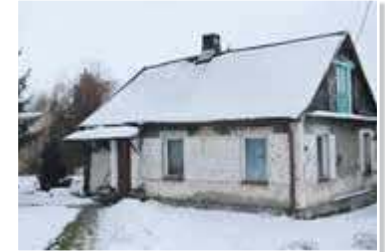
Budynek socjalny w Wisznicach przed rewitalizacją
