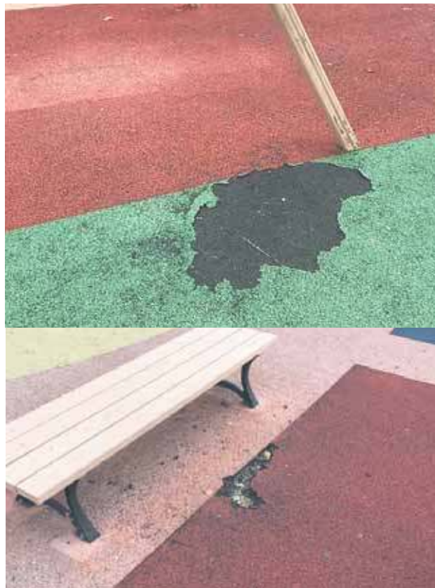
Zniszczona nawierzchnia placu zabaw
