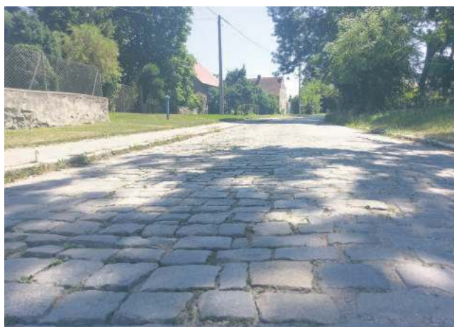
Droga w Mikoszowie ma za wąskie jezdnię i pobocza. To jedna z przyczyn braku dofinansowania na remont tego odcinka
