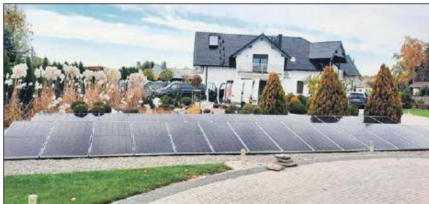
Firma oferuje pełen wachlarz usług w zakresie małych elektrowni domowych oraz farm fotowoltaicznych
