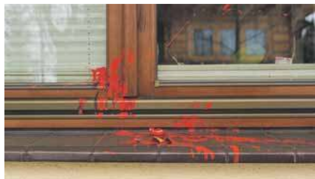
Jajka wypełnione farbą zniszczyły framugi okien.
