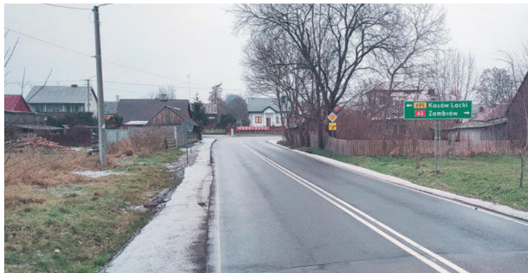
Chodnik kończy się kilka metrów za skrzyżowaniem. Kilkanaście metrów dalej nie ma już krawężnika. Można iść tylko wąskim poboczem.
