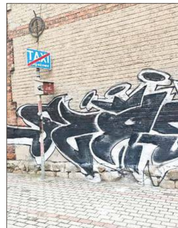
Tego graffiti już nie ma, ale autor odpowie za zniszczenie elewacji.
