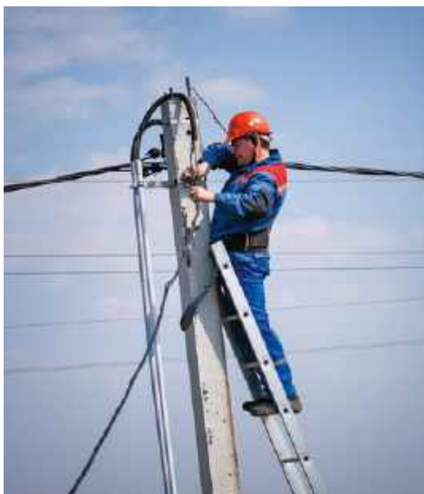
🔧 Przyłącze łączy sieć energetyczną z naszą nieruchomością. To nim płynie cała dostarczana do budynku moc. ADOBE STOCK
