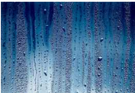
❗ Zaparowane szyby i profile okienne to oznaka problemów z wentylacją. ADOBE STOCK, WINKHAUS
