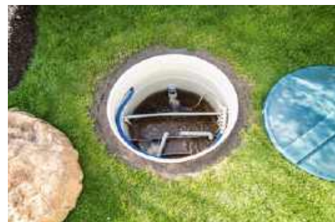
🔧 Oczyszczalnia biologiczna w przeciwieństwie do drenażowej potrzebuje zasilania prądem. Ale zajmuje mniej miejsca. EKO HOUSE TECHNOLOGIE EKOLOGICZNE
