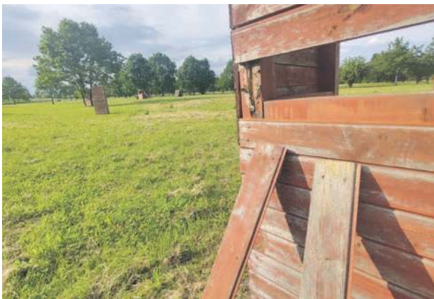
W niektórych miejscach brakuje desek
