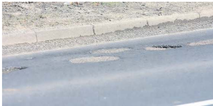
Ulica Główna. Wyremontowany odcinek drogi czeka na kolejny remont.
