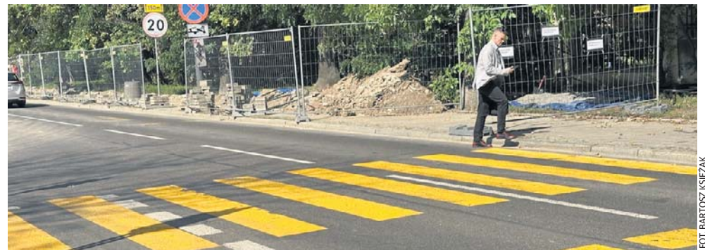
... a tymczasowe przejście prowadzi prosto na metalową siatkę.
