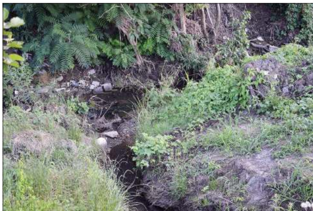
W cieku wodnym Z w samym centrum Zawady tworzy się śmietnisko z naniesionych przez wodę przedmiotów. Woda nanosi także osady do rur pod boiskiem szkolnym.
