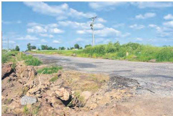
Pobocza z usuniętymi pniakami w wielu miejscach są pozarywane.
