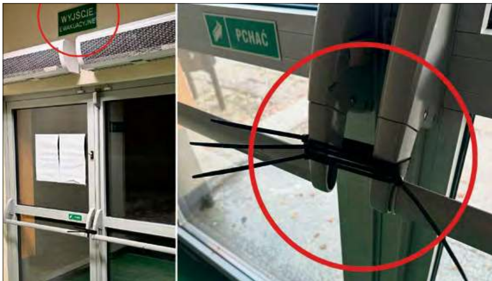
Na klamkach drzwi ewakuacyjnych Hali Widowiskowo-Sportowej im.W.Piechoty w Krapkowicach zaciśnięte są tzw. trytytki.
