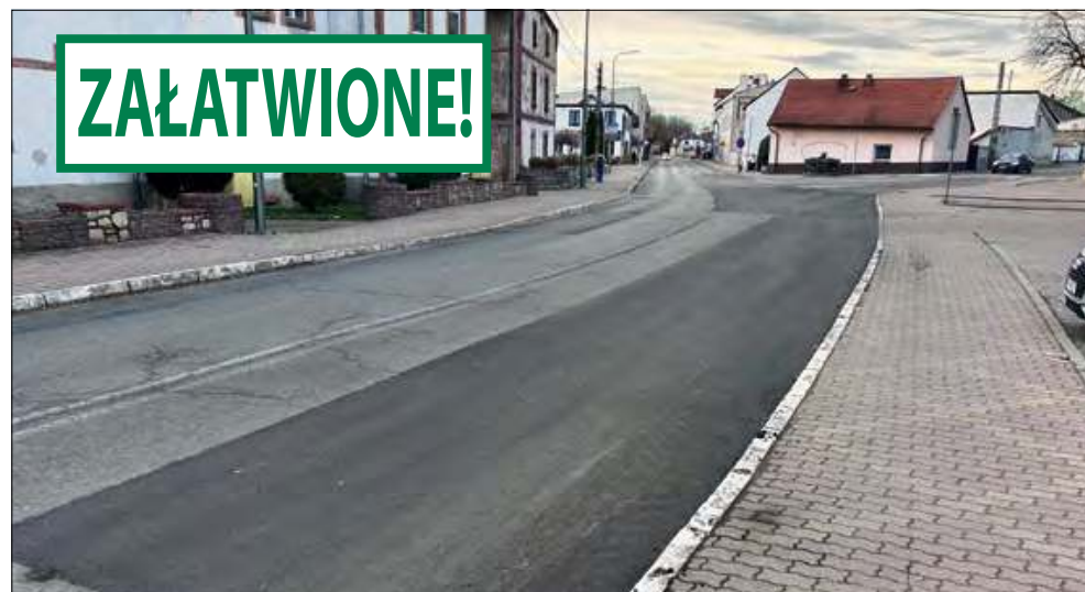
Niebezpieczne wybrzuszenie zniknęło.
