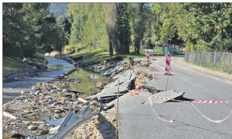
Fragment uszkodzonej drogi w pobliżu cukierni i łowisk w Moszczance
