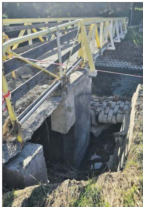
Wymyta do fundamentów podpora kładki przy Ruchomej Szopce w Łące
