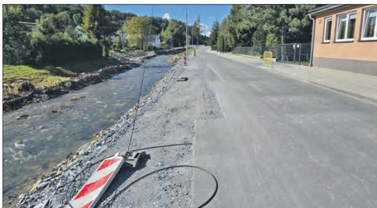
Świeżo zbudowana i uszkodzona przez powódź droga obok przedszkola w Jarnołówku już po szybkiej naprawie
