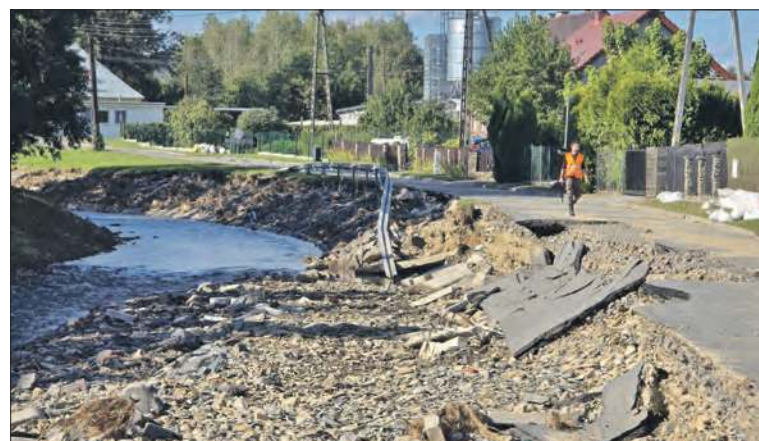
Jedno z kilku miejsc w Moszczance ze zniszczonym fragmentem drogi
