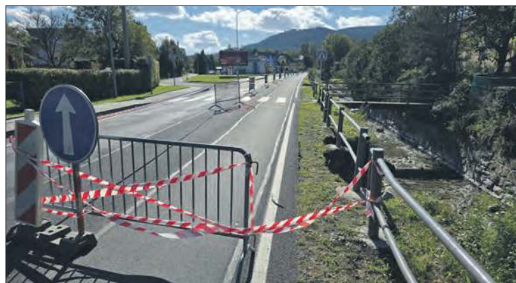
Uszkodzony brzeg przy ul. Krnovskiej w Złatych Horach.
