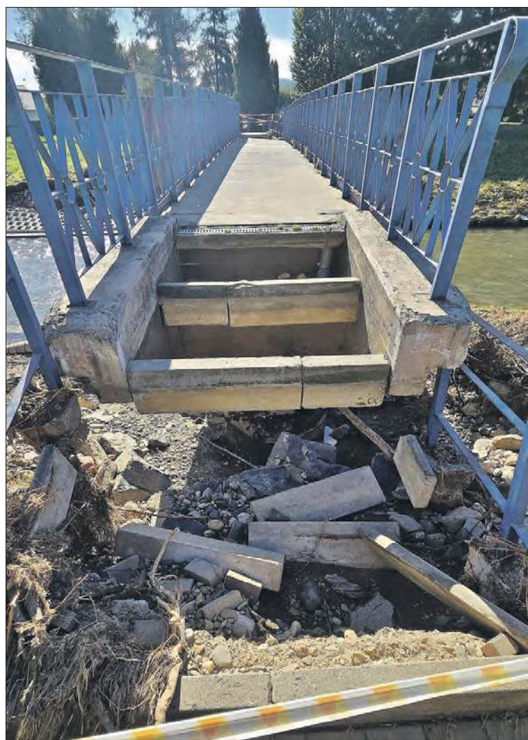
Podmyta kładka przy kościele w Łące Prudnickiej
