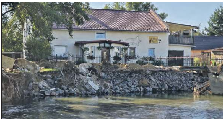
Niewiele brakowało a woda Złotego Potoku dotarłaby do dwóch budynków mieszkalnych w Łące. Rzeka zniszczyła znajdującą się przed budynkami ulicę.
