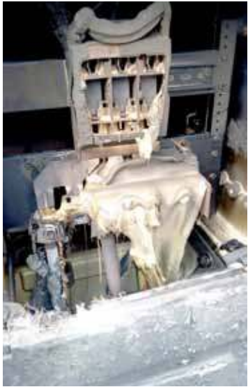
Jak widać w wyniku pożaru złącze uległo stopieniu
