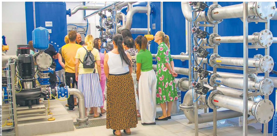
Powstała nowoczesna stacja uzdatniania wody, a na terenie całej gminy Gąbin uruchomiono system monitorowania sieci wodociągowej.
