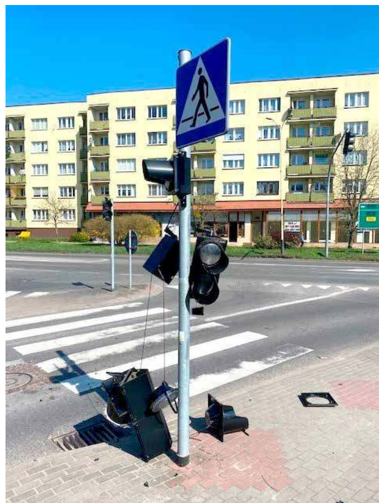
Sygnalizator został uszkodzony jeszcze w kwietniu br
