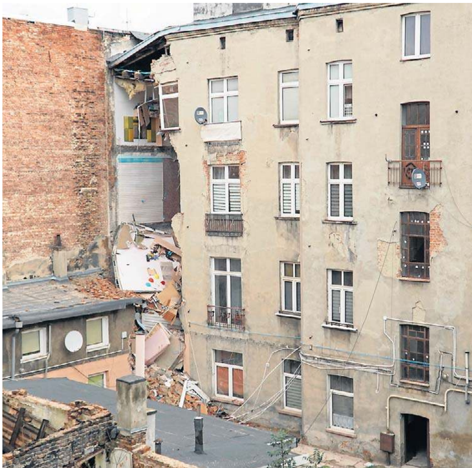
Kamienica przy al. 1 Maja 23. W piątek 6 maja najpierw zawalił się parter, a następnego dnia nie było już całej ściany oficyny
