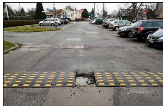
Uszkodzony próg zwalniający na ulicy Myśliwca w Zdzieszowicach.
