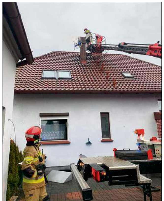
Do pożaru doszło w górnej części komina.
