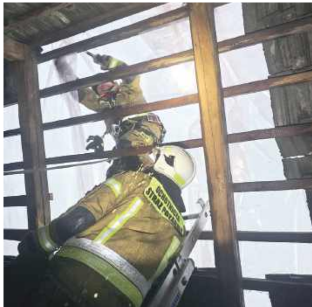
Strażacy z Aleksandrowa zabezpieczyli zerwany dach
