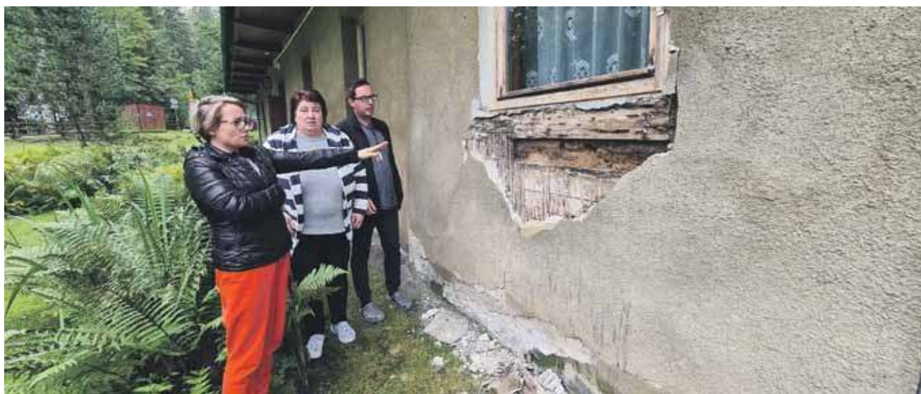
Niedawno pod jednym z okien powstała dużych rozmiarów wyrwa.
