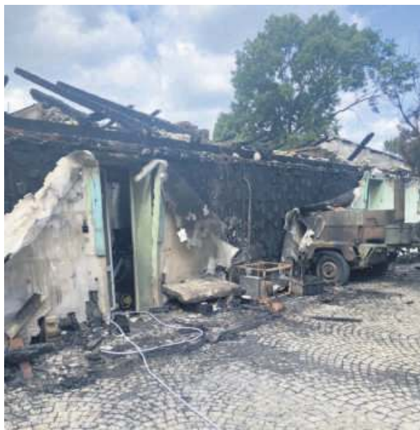
Budynek masarni spłonął całkowicie
