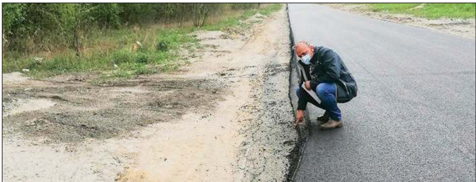
Nowy dywanik asfaltowy został położony, ale niestety konieczne są poprawki. Bez nich kierowcy mogą uszkodzić zawieszenie w autach
