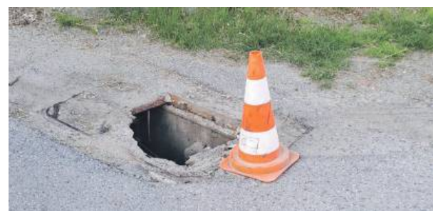
Na skrzyżowaniu ulic Kolejowej i Ogrodowej w Przewornie zapadła się płyta studzienki telekomunikacyjnej
