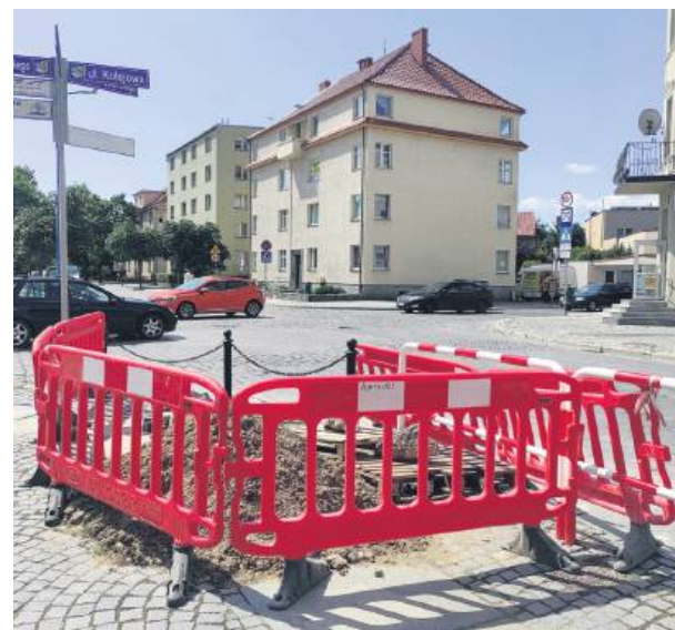
Przy remoncie jednej ze studzienek na skrzyżowaniu ul. Bolka I Świdnickiego i ul. J. Piłsudskiego odkryto problem związany z uszkodzeniem przykanalików
