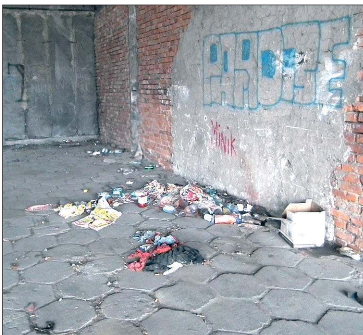
Garaże przy ul. Akademickiej pełne są m.in. butelek, szmat i niedopałków.
