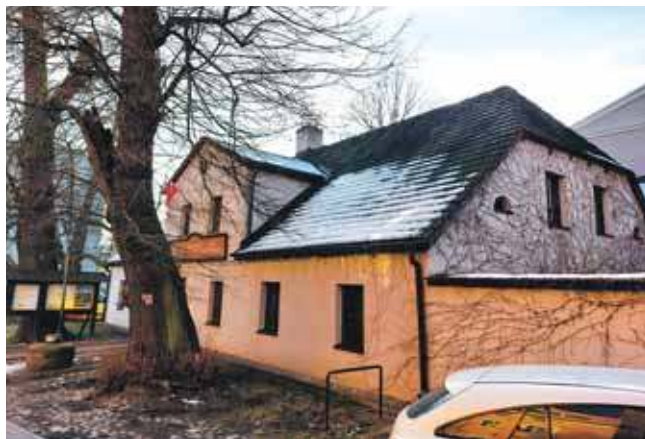
Dach dworku był remontowany na początku XXI wieku, ale zastosowano wówczas gont tak niskiej jakości, że liczne przecieki spowodowały uszkodzenie konstrukcji dachowej
