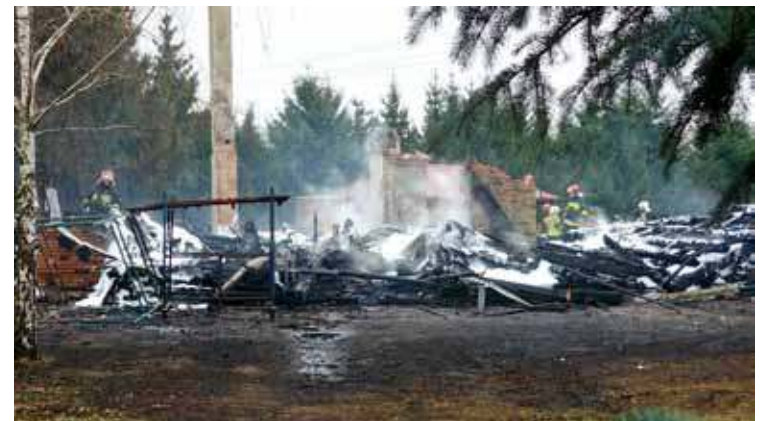
W wyniku pożaru nowo budowany dom uległ całkowitemu spaleni.
