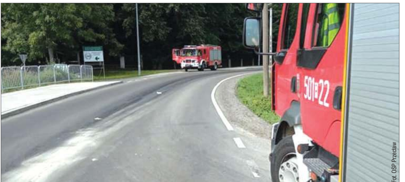
Wykonane uszczelnienie emulsją asfaltową nie zdążyło wyschnąć.
