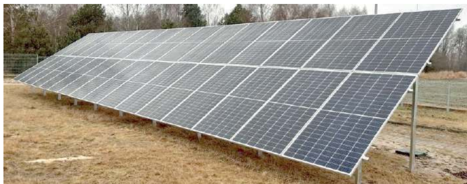
Prace już się zakończyły. Moc instalacji to 34 kW
