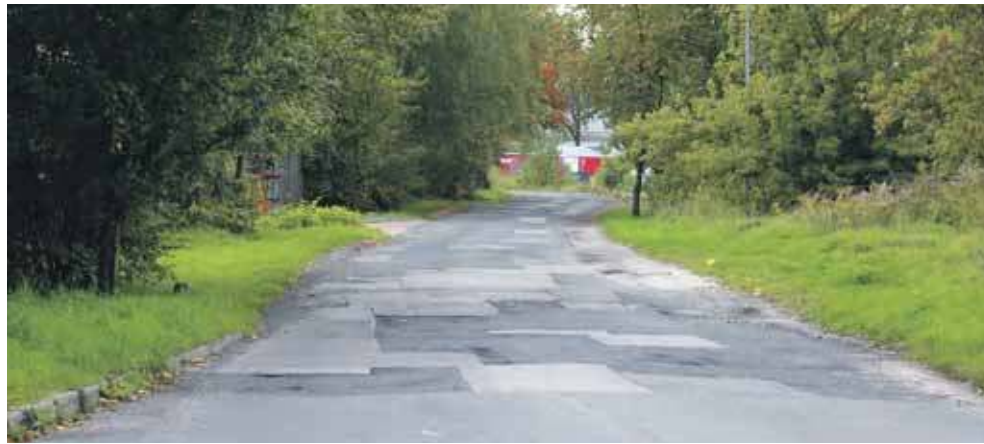
Nawierzchnia w kratkę i dziury – to stan ul. Polnej w Lasowicach
