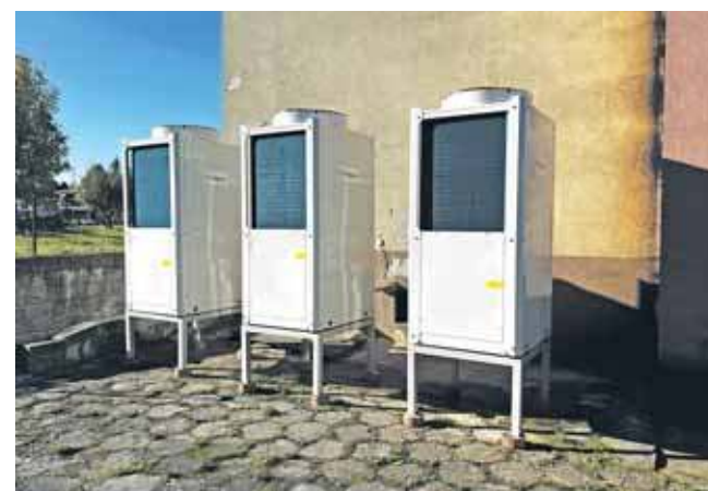
Przy budynku przy ul. Wyzwolenia 4a stanęła kaskada 3 pomp ciepła, o łącznej mocy 120kW
