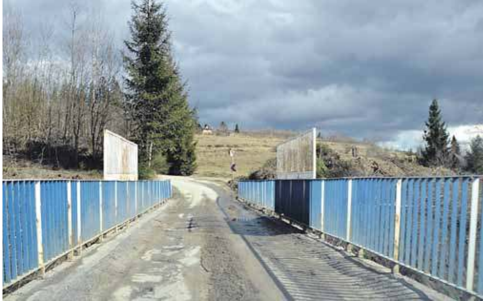
Wąski most nad torami kolejowymi od dawna prosi się o remont. Ale inwestycja szacowana jest na 9 mln zł i bez dofinansowania z zewnątrz powiatu nie stać na to, aby ją wykonać.
