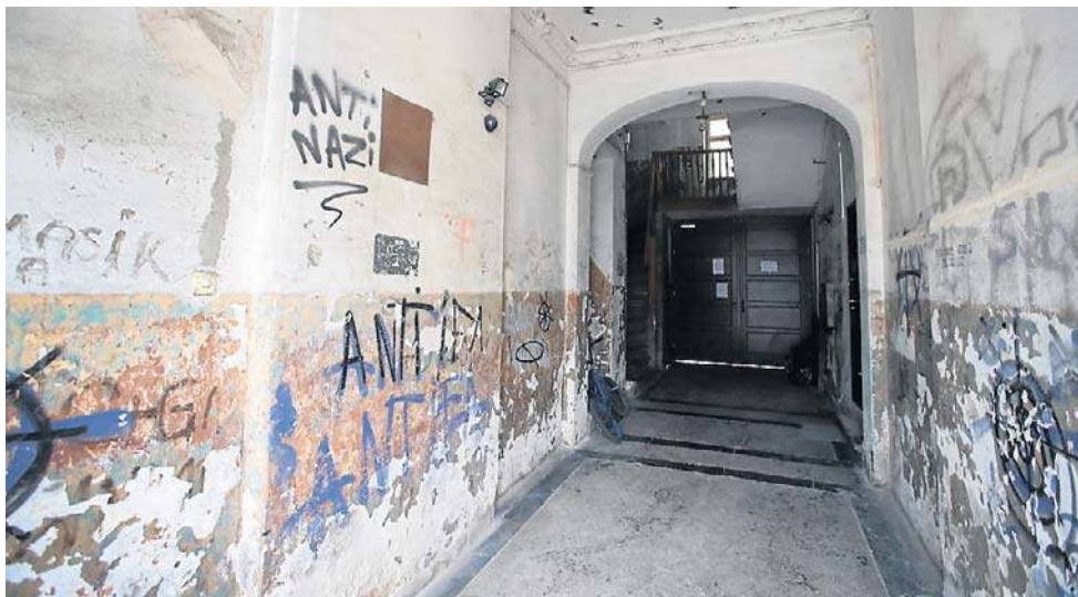
Lokatorzy budynku przy ul. Kolumba 6 twierdzą, że klatka schodowa wygląda jak w melinie. Nie jest to jedyny problem w tej kamienicy
