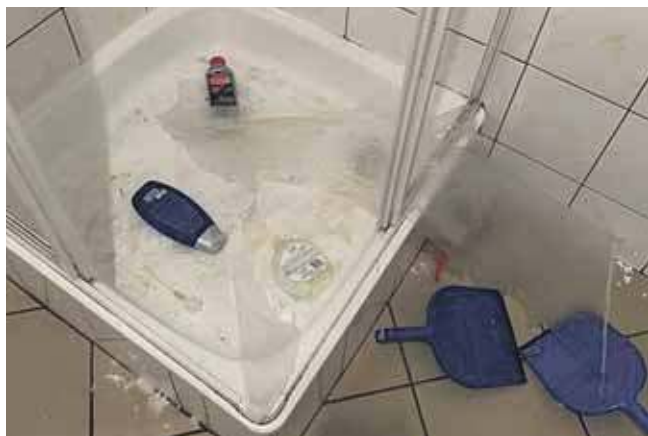
Zdewastowano m.in. prysznice
