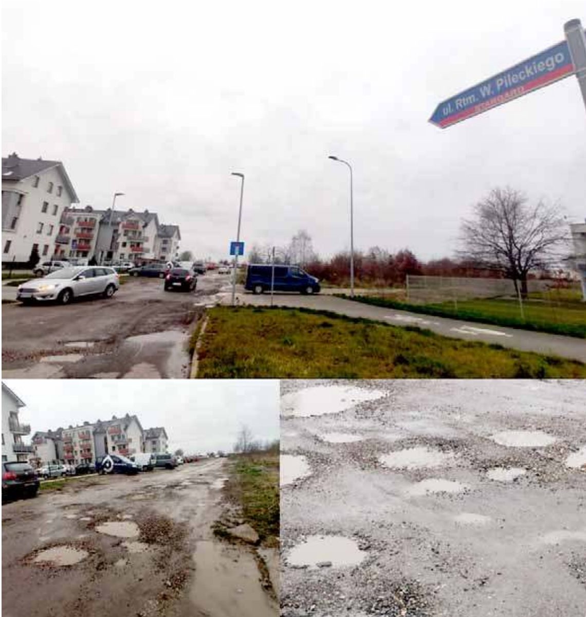
Ze względu na spór miasta i wykonawcy od 10 lat mieszkańcy ul. Rotmistrza Pileckiego czekają na remont drogi
