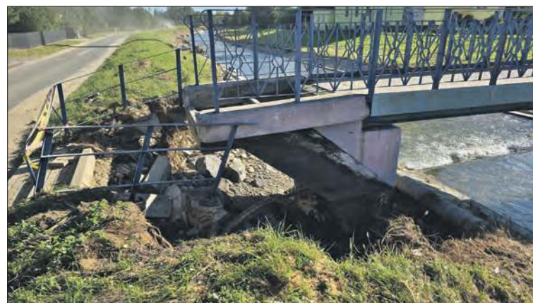
Zniszczone przęsło kładki w Łące Prudnickiej
