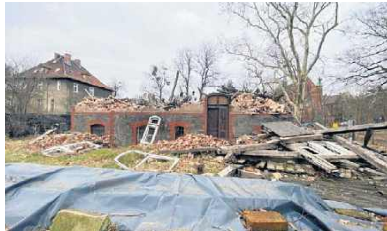
Zniszczona willa. Kolejne terminy rozpraw - w listopadzie i grudniu
