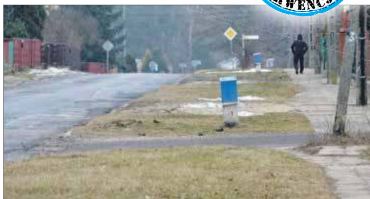
Stan nawierzchni ul. Twardej i biegnący wzdłuż niej chodnik lata swojej świetności mają już dawno za sobą. Mieszkańcy chcą remontu tej głównej ulicy osiedla
