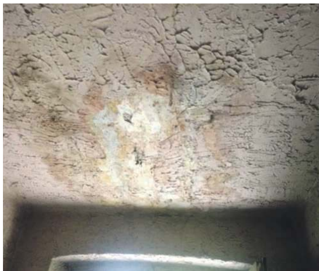
Zalany sufit w kolejnym pomieszczeniu
