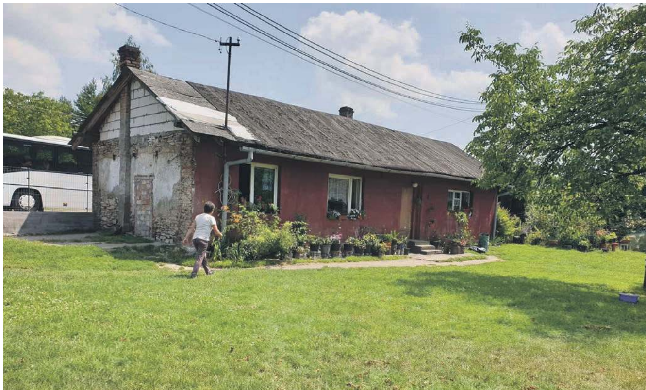
Duży, ładny ogród i stary dom. Dach nadaje się do wymiany
