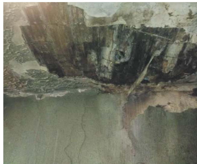
Dziura w suficie w jednym z pomieszczeń
