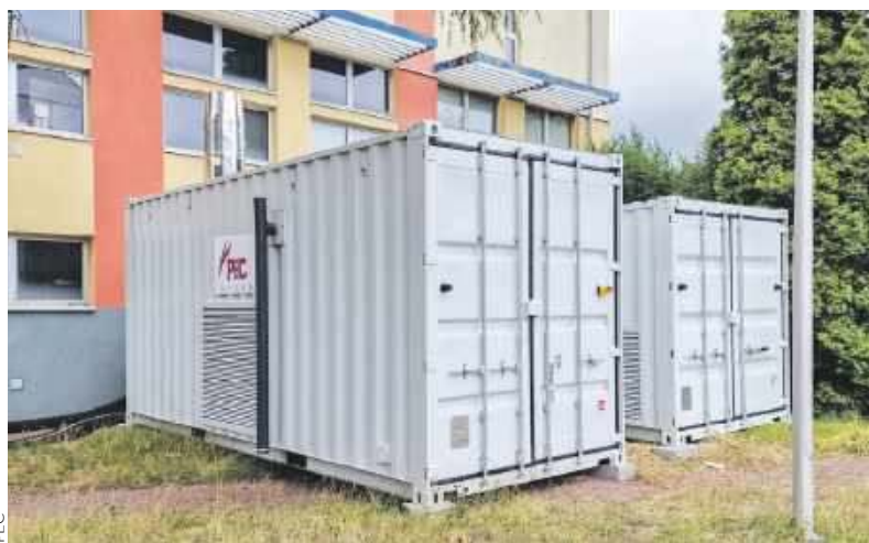
Kotłownie kontenerowe PEC
