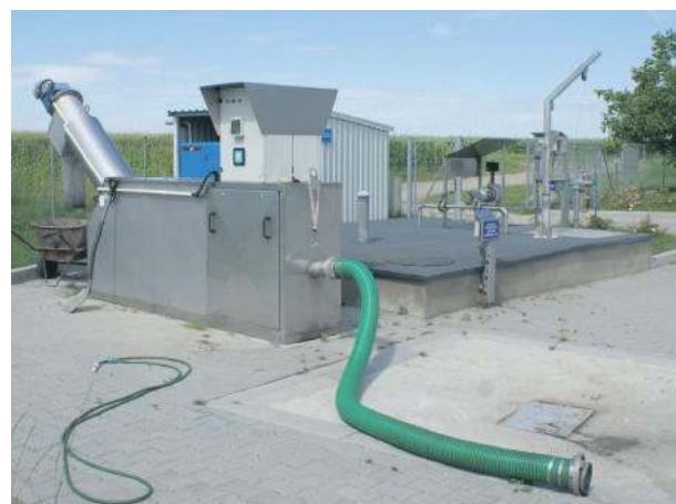
Oczyszczalnia w Borku Strzeleńskim posiada instalacje do obsługi wozów asenizacyjnych
