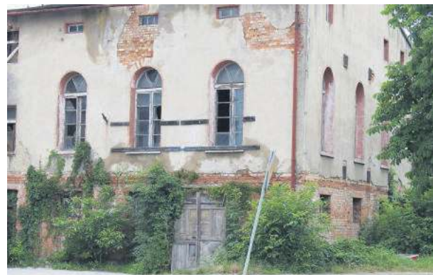
Zrujnowany i zarośnięty, stary budynek zakładu stający w centrum miasta u zbiegu ulic Oławskiej i Wrocławskiej. Należał do nie działającej już spółdzielni pracy Hibner
