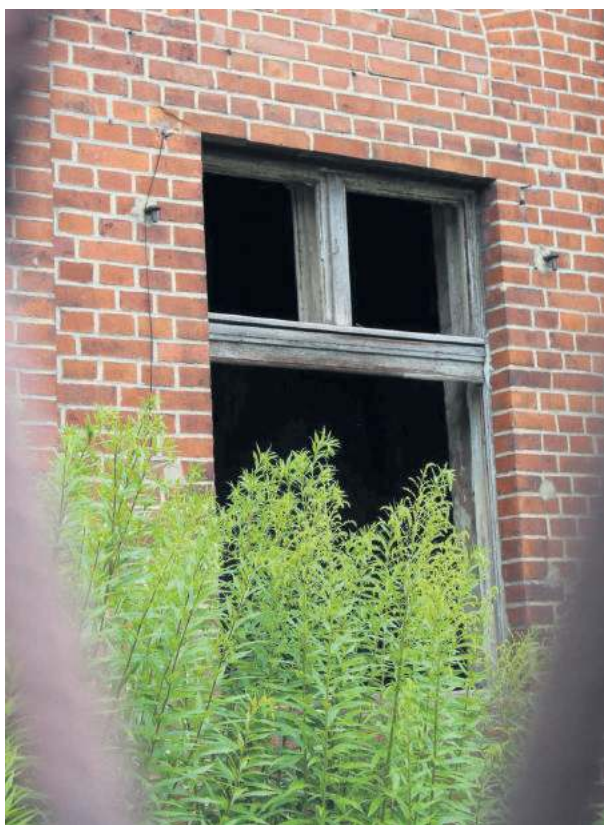
Ruiny jednego z budynków produkcyjnych. Na starość i zły stan budynku wskazuje wybite, drewniane, duże okno
